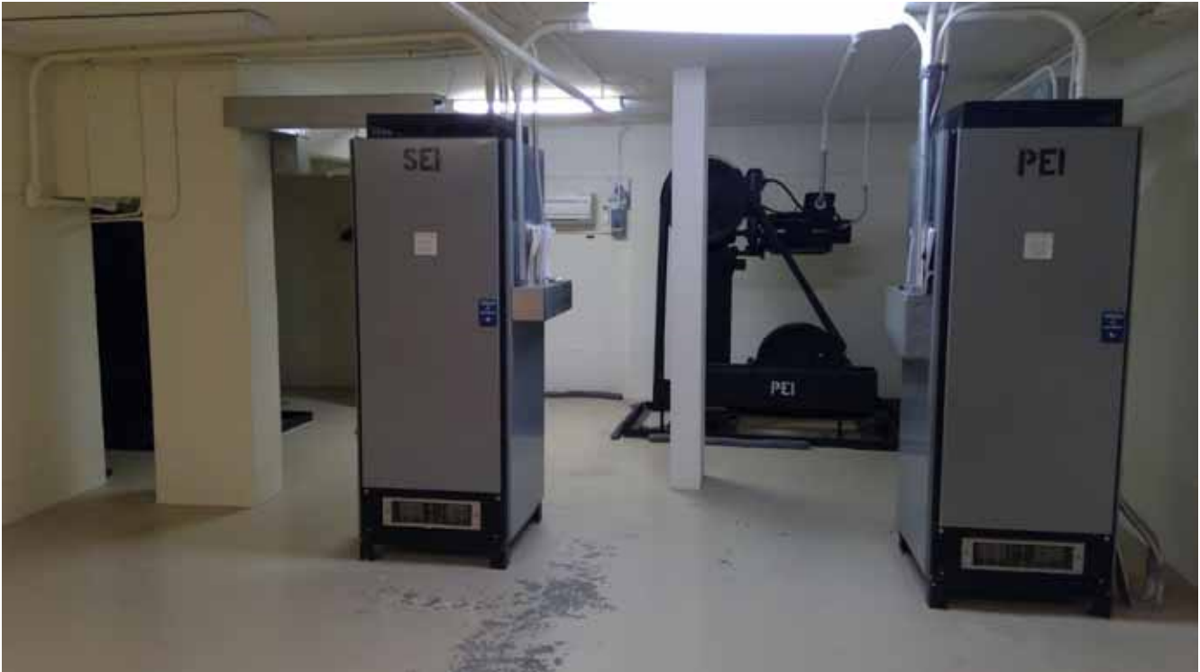
Elevator Equip Room - North
